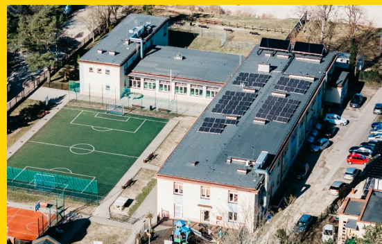
Montaż paneli fotowoltaicznych na budynkach Szkoły Podstawowej w Jastrzębiej Górze oraz Szkoły Podstawowej nr 2 i Zespołu Szkół nr 1 we Władysławowie w ramach programu „Słoneczne Szkoły Powiatu Puckiego”
